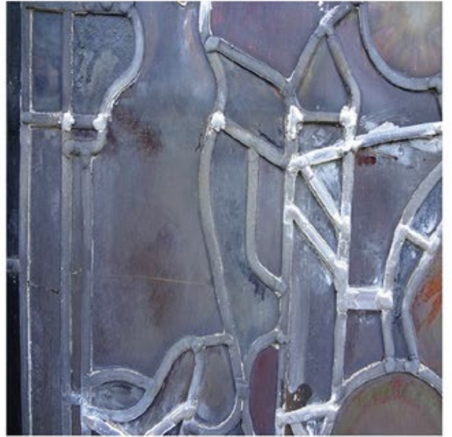
反射光でのパネルの現状
